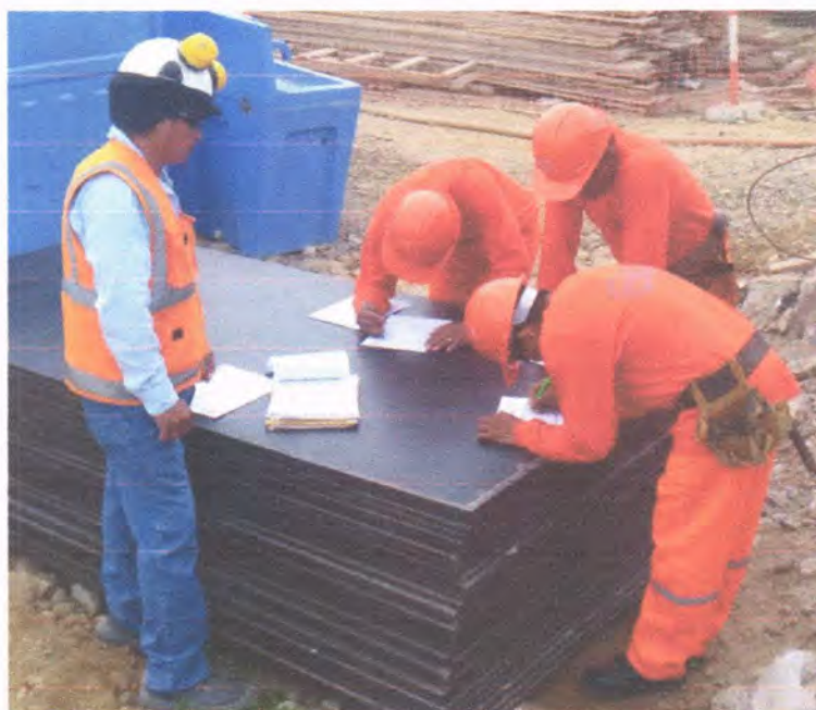
Foto 2: El supervisor SSOMA, realiza la inducción a un grupo de colaboradores nuevos para el ingreso a Obra.
